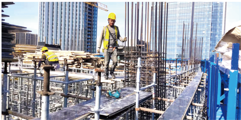
◀5月1日,中建八局四公司的工人在即墨区陆港临空云创中心项目现场作业。
